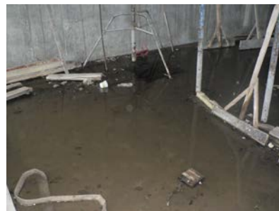
Рис. 3. Затопление подвала здания атмосферными водами
