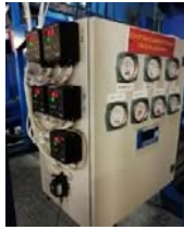
Рис.2 Щит КИП с термо регуляторами
