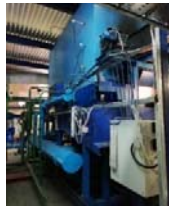
Рис.5 Приборы измерения котла КВП-1,74 ВТКС
