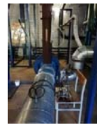
Рис.7 Приборы измерения расхода и давления воздуха и газов рециркуляции
