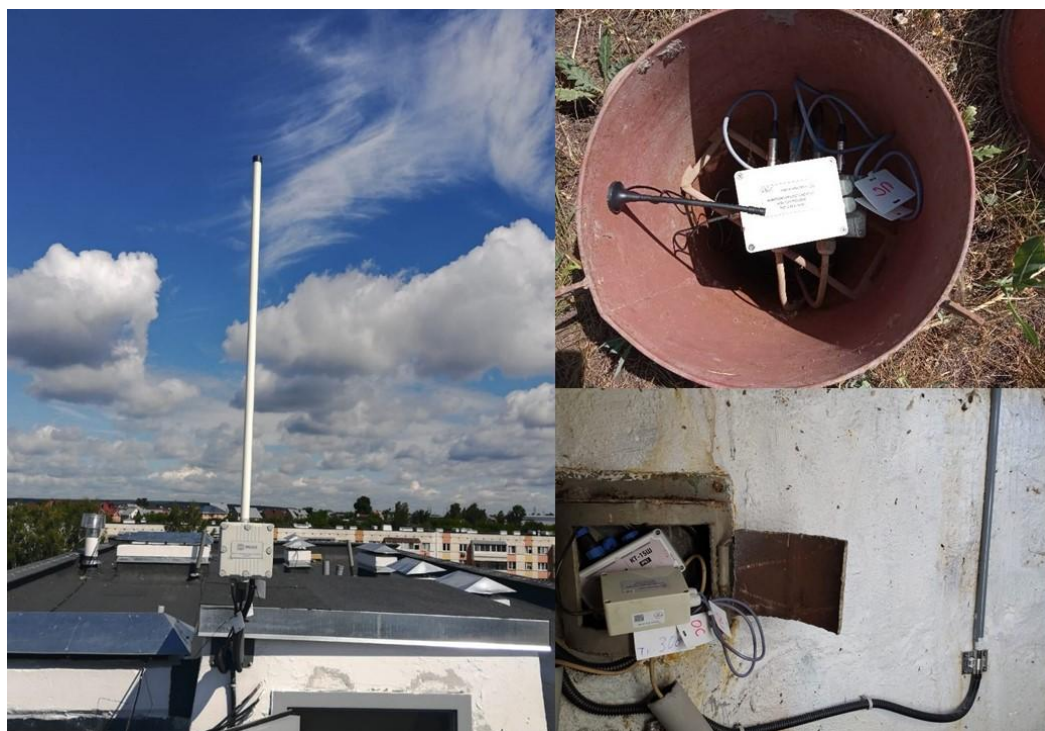
Рис. 2. – Дистанционный сбор показаний системы оперативного дистанционного контроля трубопроводов с использованием технологии LoRaWAN. Базовая станция на крыше жилого дома (слева), устройство диагностики в наземном ковре (верхний рисунок справа), устройство диагностики в тепловой камера (нижний рисунок справа)
